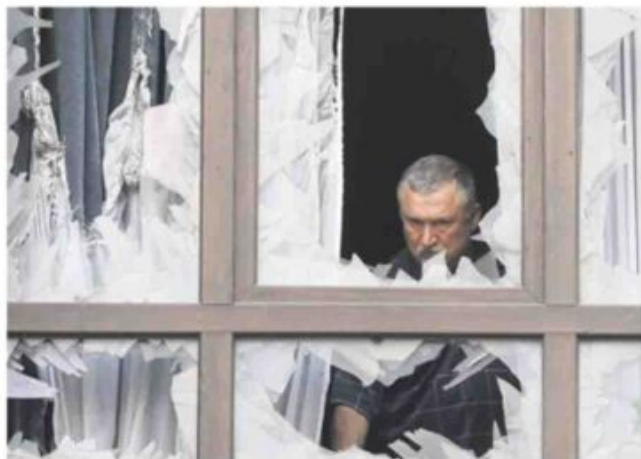
Schäden nach einem Drohnenangriff in Kiew, 21. Juli 2025.
